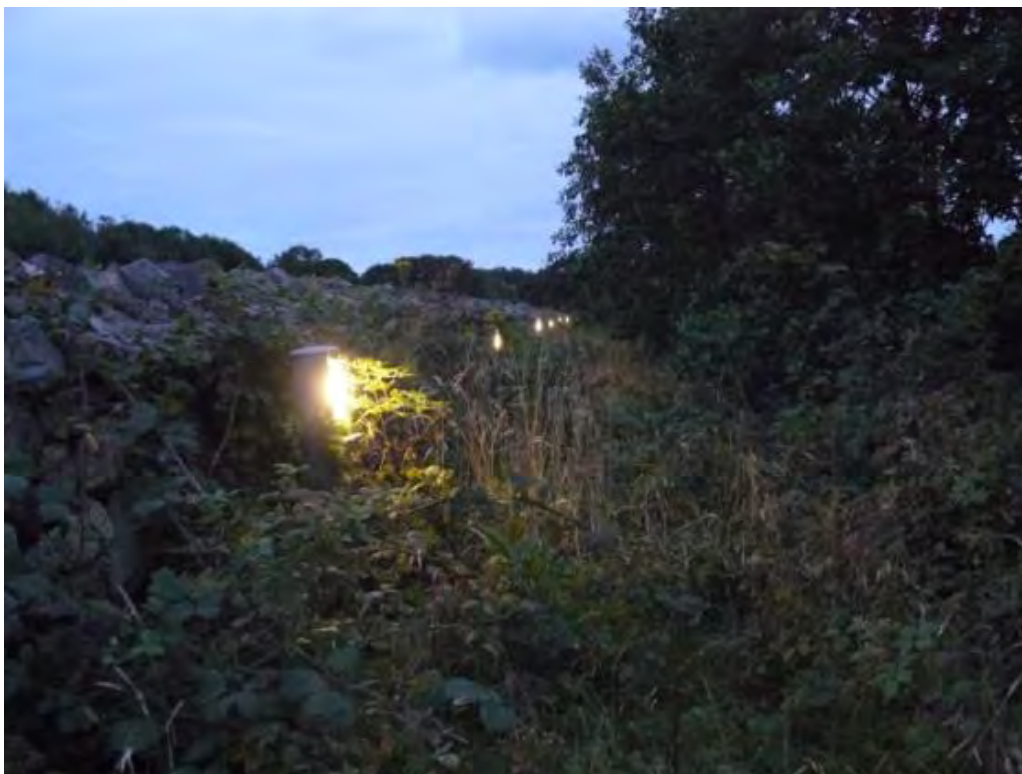
Figuur 4-8 - Lichtarmaturen in de berm van de N 487. De verlichting wordt gebruikt om vleermuizen in de omgeving van de weg te verjagen en ze te leiden naar een veilige passeerplaats.
