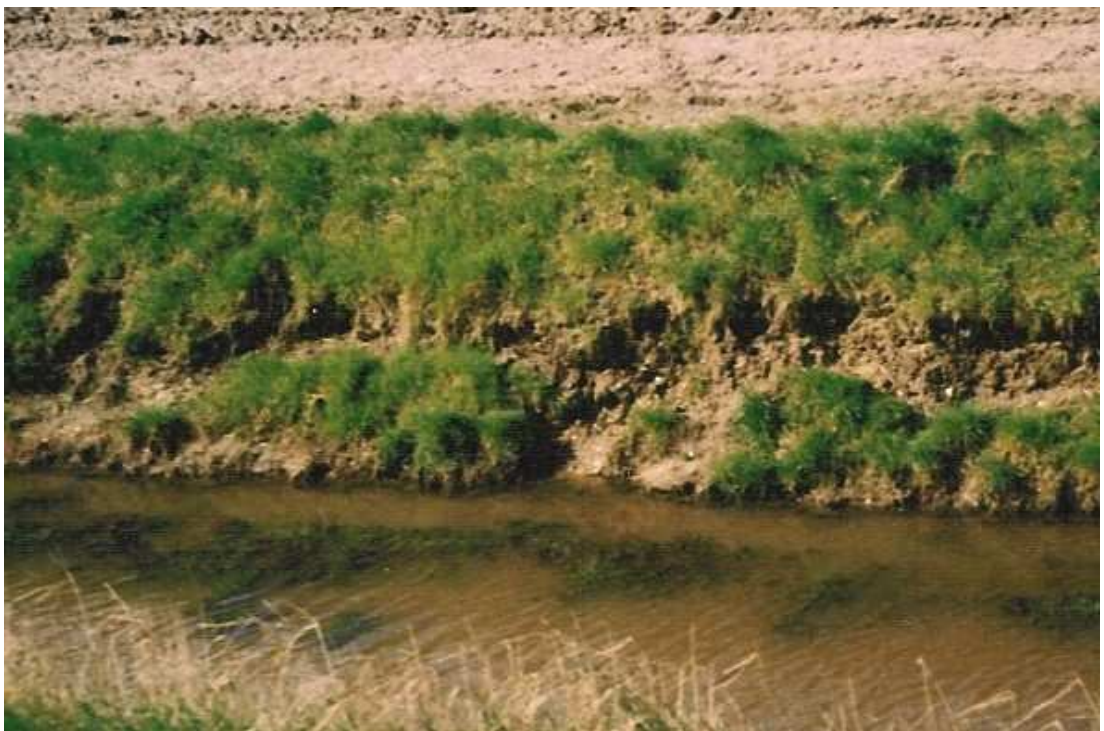
Oeverschade door Muskusratten (foto LCCM)
