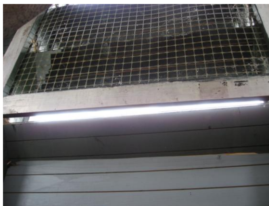
3B. Gaas dat niet heel nauwkeurig is geplaatst geeft vleermuizen de gelegenheid om alsnog binnen te komen.
